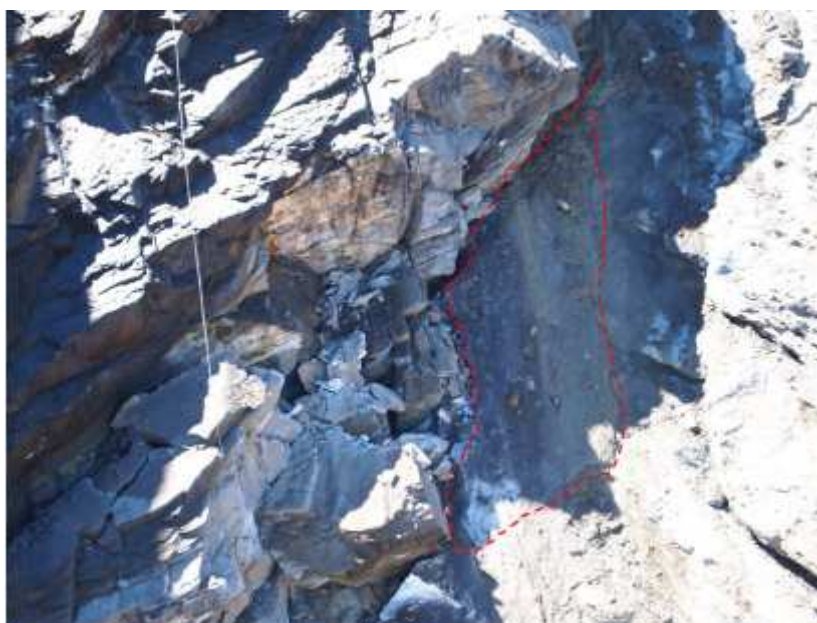
Abb. 32: Detail Ablösebereich des Felssturzes
