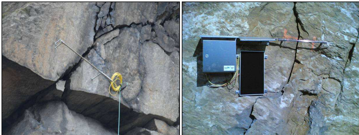
Abb.8: Fissurometer mit Kabelanbindung
