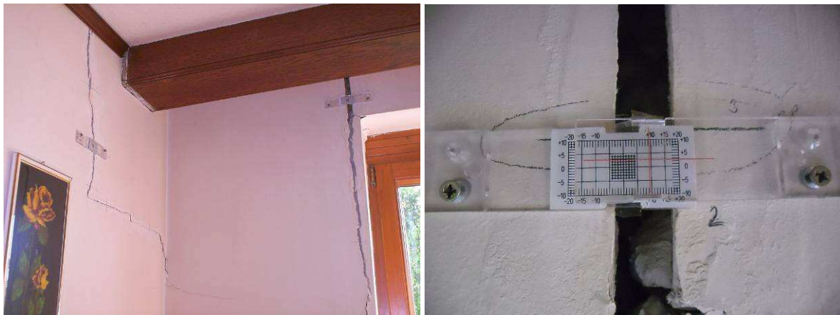
Abb.1: Risse in Wohnhaus in Scharndorf, Kunststoffissurometer
